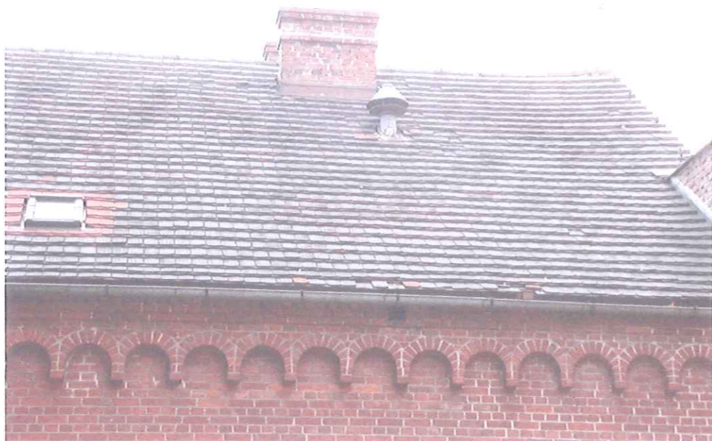
fot. 3 Uszkodzenia pokrycia; ugięcie krokwi przy ścianie szczytowej („siodło”)
